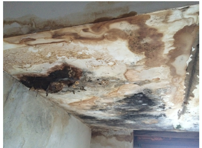
Decke Wohnraum Dachgeschoss - Wasserschaden deutlich sichtbar
