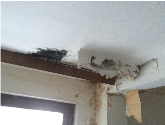
Decke Wohnraum Erdgeschoss - Schimmelbildung
