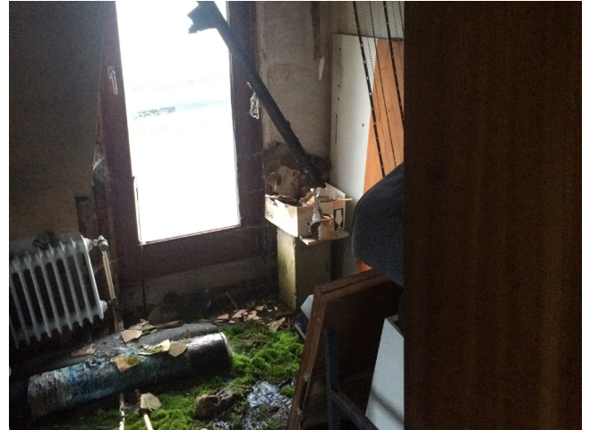
Wohnraum Dachgeschoss - Wasserschaden deutlich sichtbar
