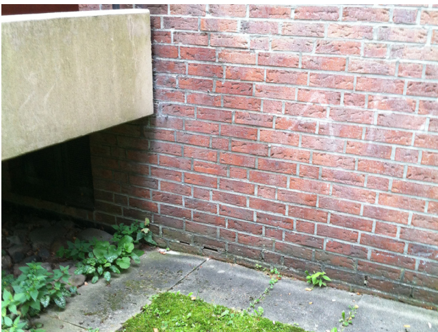
Mängel im Sockelbereich (Offene Verfugung)
