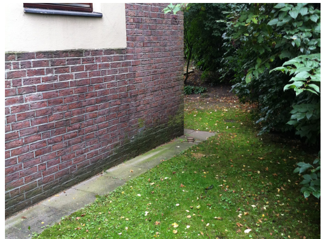
Starke Durchfeuchtung oberhalb der verlegten Betonplatten (Spritzwasserzone!)
